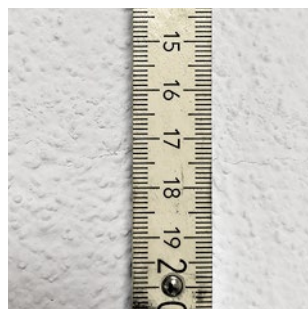
Après le renforcement, la fissure est fermée
