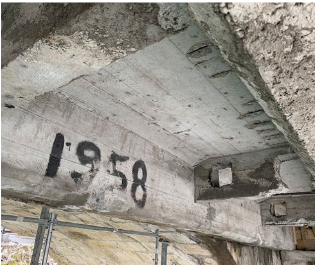
Béton endommagé avant le renforcement
